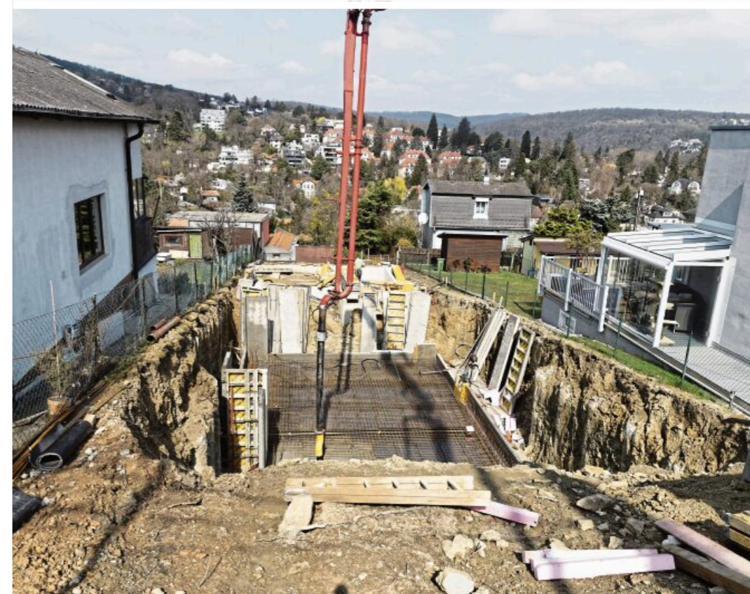
Rechts und links der Baugrube ist kaum Platz, die gesamte Breite wird für den Hausbau genutzt
